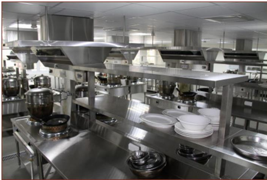
中餐一教室-爐台設備
